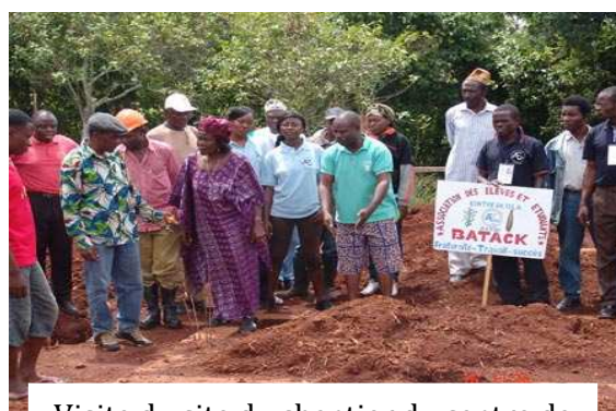
Visite du site du chantier du centre de santé de Batack des jeunes de l'AEEBA et du COVIDEBA
